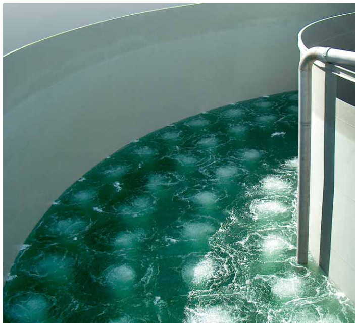
Nitrifikationsstufe von BIOFIT®N mit AEROFIT®D Belüftungssystem im Testbetrieb
